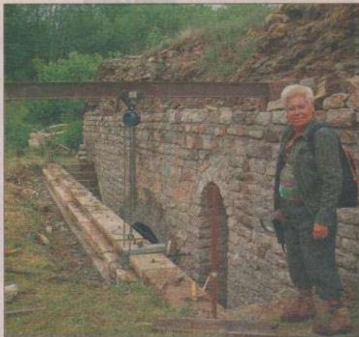
Les travaux de remise en état de l'ouvrage militaire se poursuivent. La présidente, Myriam Michel, y participe activement.
