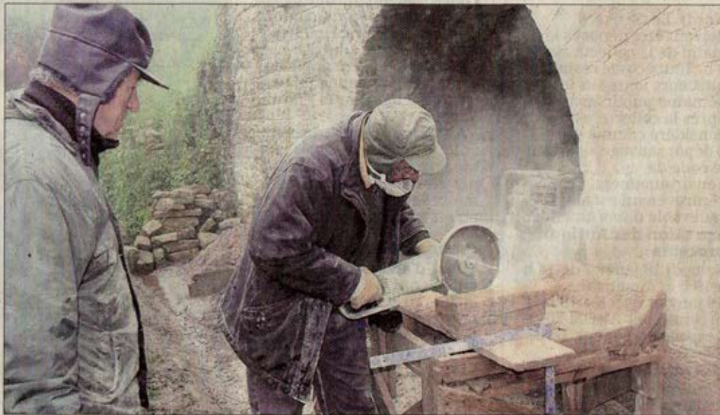
■ Chaque mercredi, une vingtaine de bénévoles se retrouve au fort afin de poursuivre la réhabilitation de ce vestige du passé.
